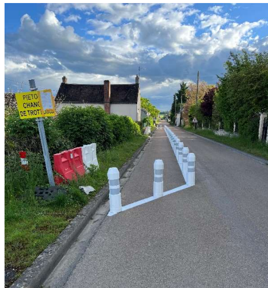
La chaussée risquant de s'effondrer, par précaution, le Département a réduit la route rue Léopold Javal pour sécuriser la maison du dessous. Les travaux seront effectués en 2025. Attention zone à 30 km/h.
